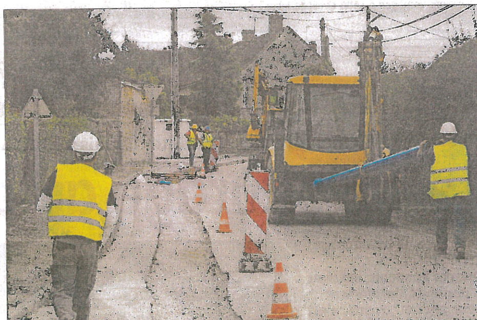
EAU POTABLE. Le remplacement des anciennes conduites en fonte sera suivi par la rénovation de branchements.
